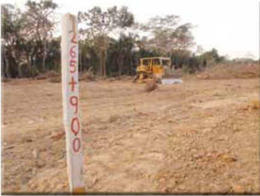
En el tramo III, sin consulta previa ya se construye la carretera. Foto: Roberto Morales.
